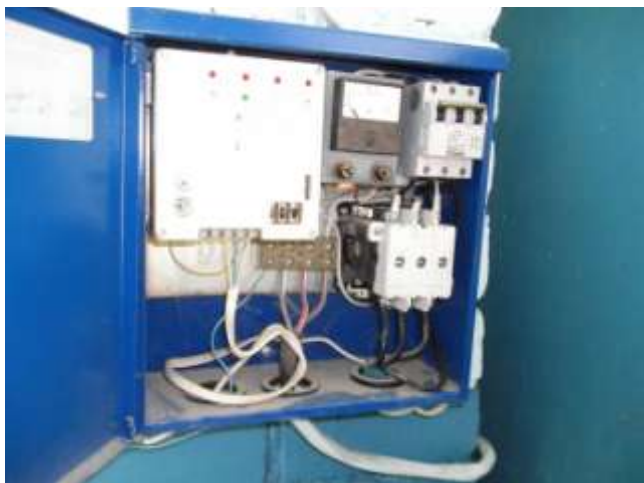
Фото 1.4.13 Щиток управления скважиной №1229 с. Сущёво
