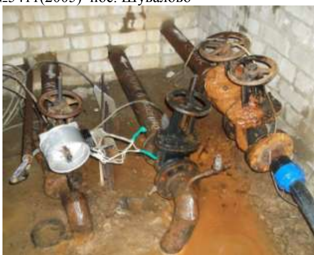
Фото 1.4.23 Оборудование артезианское сква- жины под водонапорной башней пос. Шувалово
