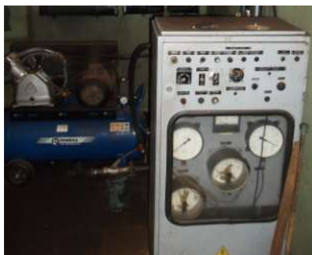
Фото 1.4.24 Компрессорное оборудование стан- ции обезжелезивания пос. Шувалово
