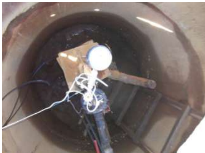
Фото 1.4.14 Подземное размещение скважины молокозавода №... с. Сущёво
