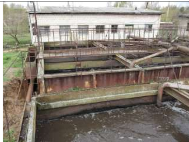
Фото 9.1.12 Аэротенки и здание ОСК в пос. Прибрежный
