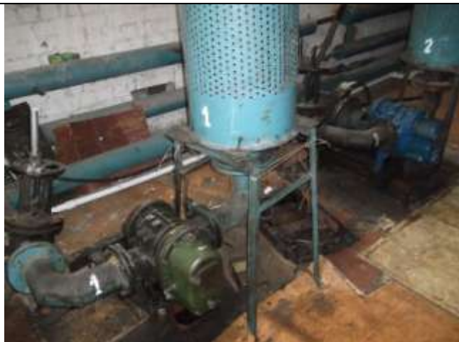
Фото 9.1.15 Неисправный компрессор ОСК пос. Шувалово
