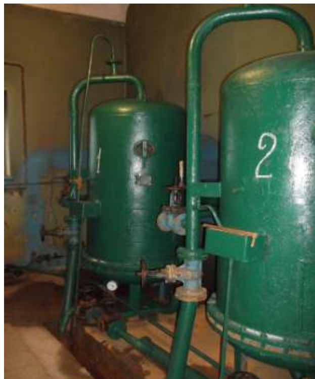
Фото 1.4.20 Фильтры станции обезжелезивания пос. Шувалово
