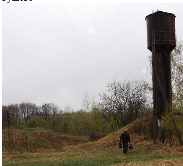
Фото 1.4.18 Скважина и водонапорная башня в оздоровительном лагере с. Сущёво
