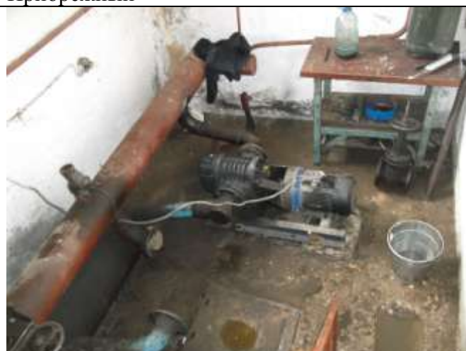
Фото 9.1.10 Компрессор в здании очистных сооружений канализации пос. Прибрежный
