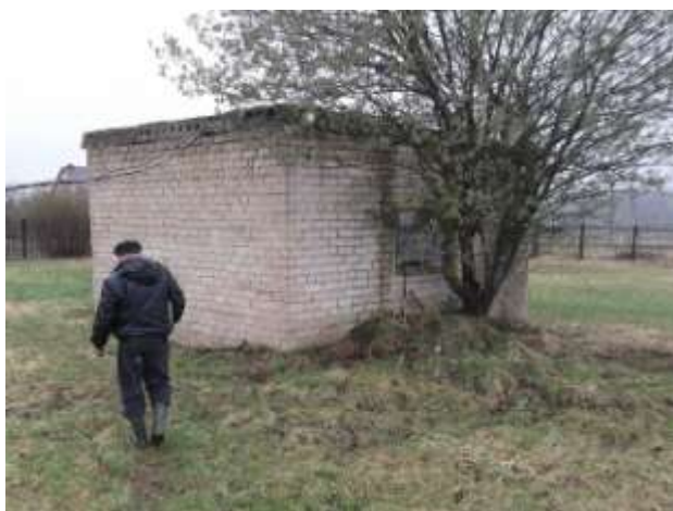
Фото 1.4.21 Строение ЩУ скважины №5411(2005) пос. Шувалово
