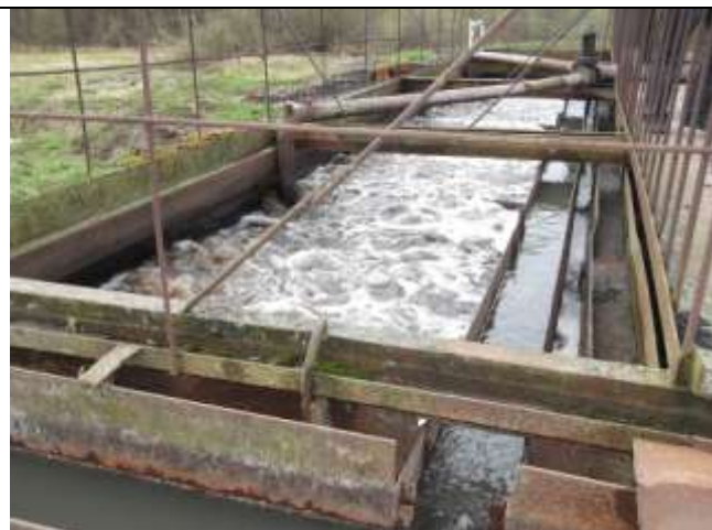
Фото 9.1.8 Аэротенки в работе на ОСК в пос. Прибрежный
