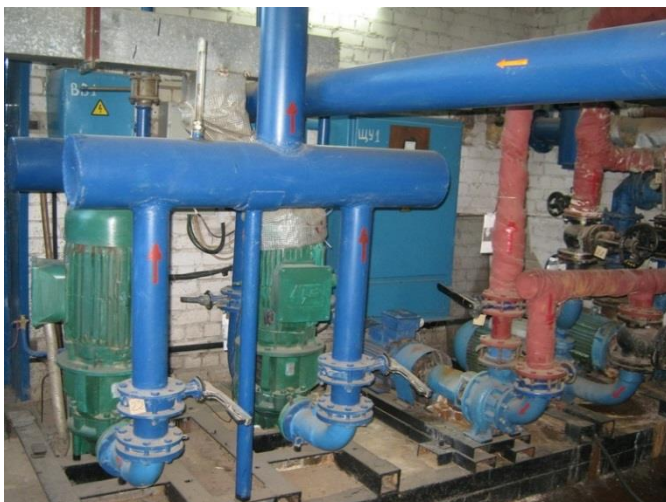
Рисунок 1.2.3 – Сетевые и котловые насосы в котельной п. Шувалво
