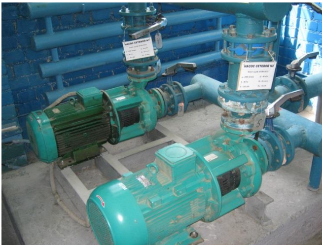
Рисунок 1.2.11 – Сетевые насосы в котельной с. Сушево
