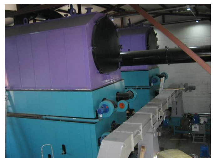
Рисунок 1.2.6 – Котлы КВТ 2000 в котельной п. Прибрежный
