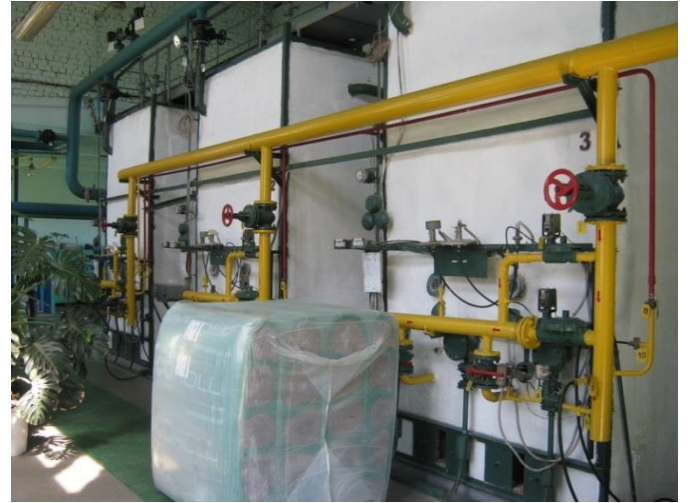
Рисунок 1.2.8 – Котлы в котельной с. Сушево
