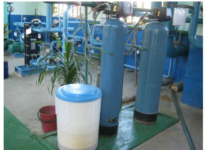
Рисунок 1.2.10 – Автоматизированная водоподготовительная установка в котельной с. Сушево
