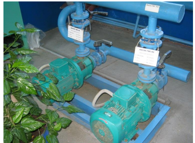
Рисунок 1.2.12 – Насосы ГВС в котельной с. Сушево
