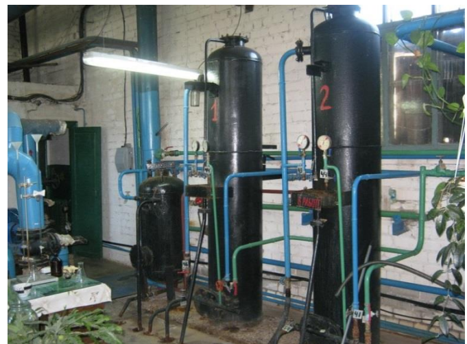
Рисунок 1.2.4 – Водоподготовительная установка в котельной п. Шувалово
