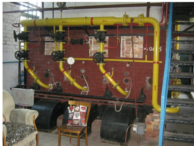
Рисунок 1.2.2 – Котел КВГ-4,65 в котельной п. Шувалово
