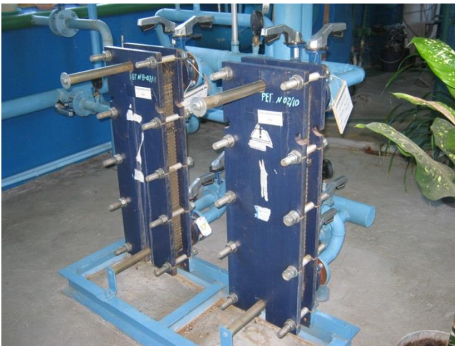
Рисунок 1.2.9 – Пластинчатые теплообменники ГВС в котельной с. Сушево
