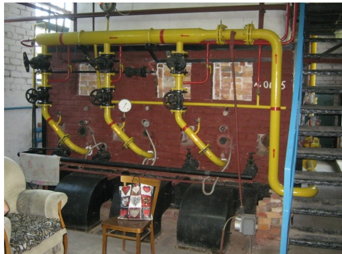
Рисунок 1.2.2 – Котел КВГ-4,65 в котельной п. Шувалово
