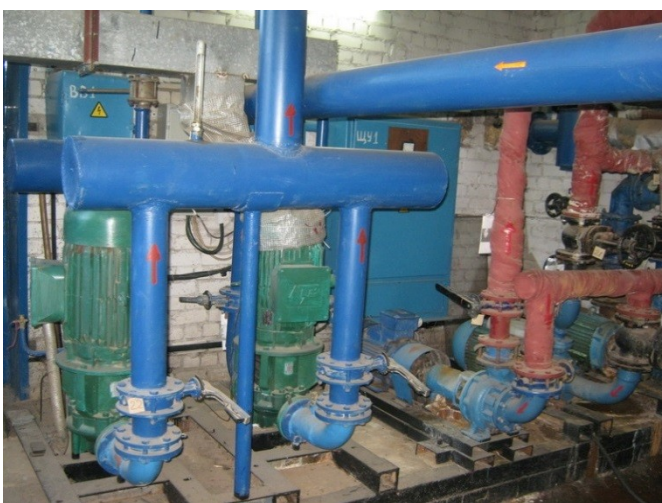
Рисунок 1.2.3 – Сетевые и котловые насосы в котельной п. Шувалово
