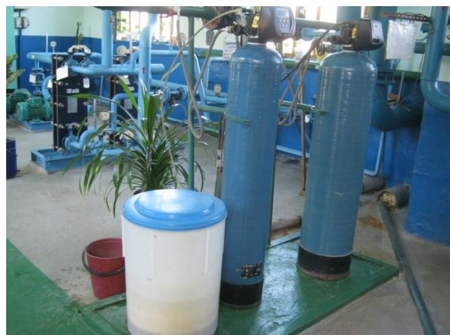
Рисунок 1.2.10 – Автоматизированная водоподготовительная установка в котельной с. Сущево
