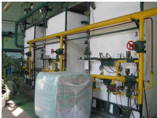
Рисунок 1.2.8 – Котлы в котельной с. Сущево
