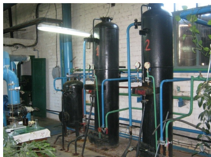
Рисунок 1.2.4 – Водоподготовительная установка в котельной п. Шувалово
