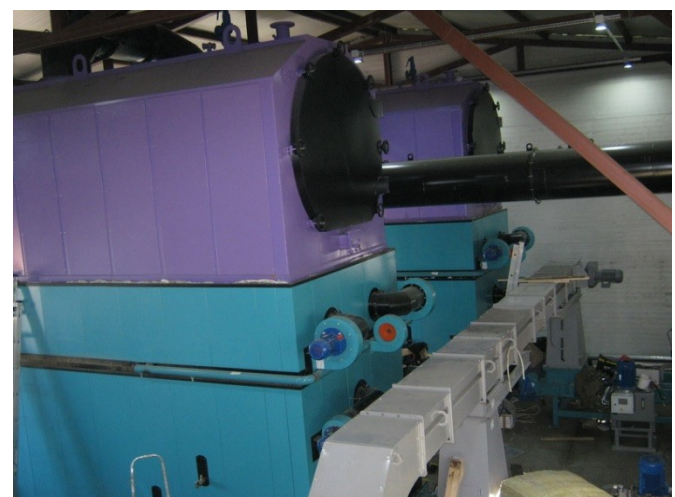
Рисунок 1.2.6 – Котлы КВТ 2000 в котельной п. Прибрежный
