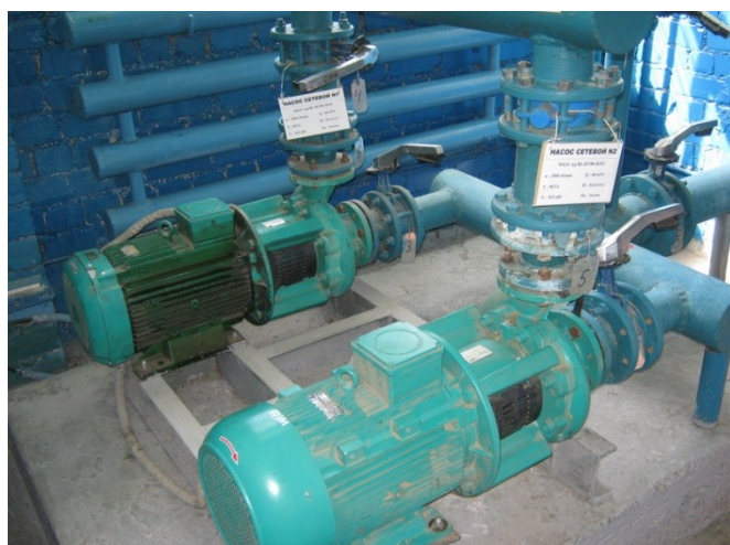
Рисунок 1.2.11 – Сетевые насосы в котельной с. Сущево
