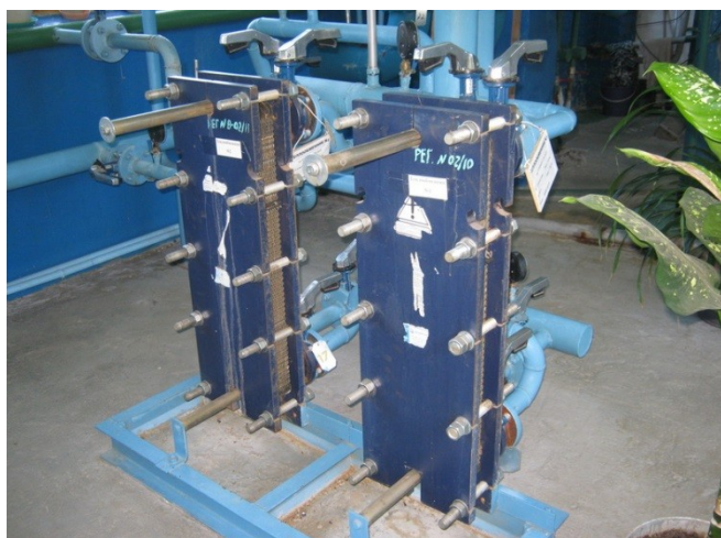
Рисунок 1.2.9 – Пластинчатые теплообменники ГВС в котельной с. Сущево
