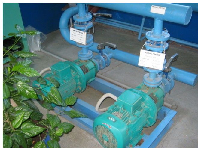
Рисунок 1.2.12 – Насосы ГВС в котельной с. Сущево
