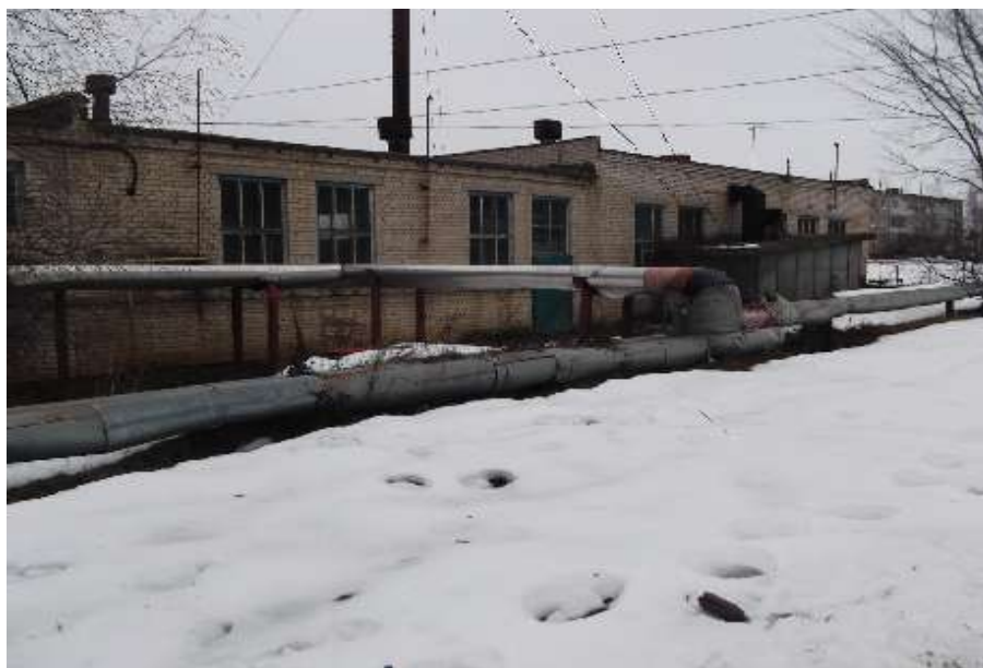
Рис.1.2.2.1 – Котельная п. Шувалово, ул. Победы
